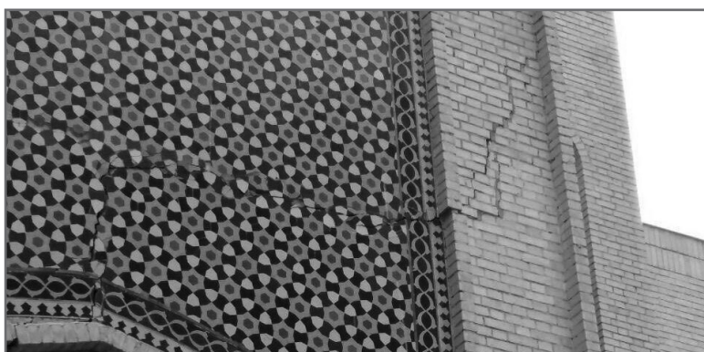
ترک‌های سردر بازار رضا پس از وقوع زلزله صبح
